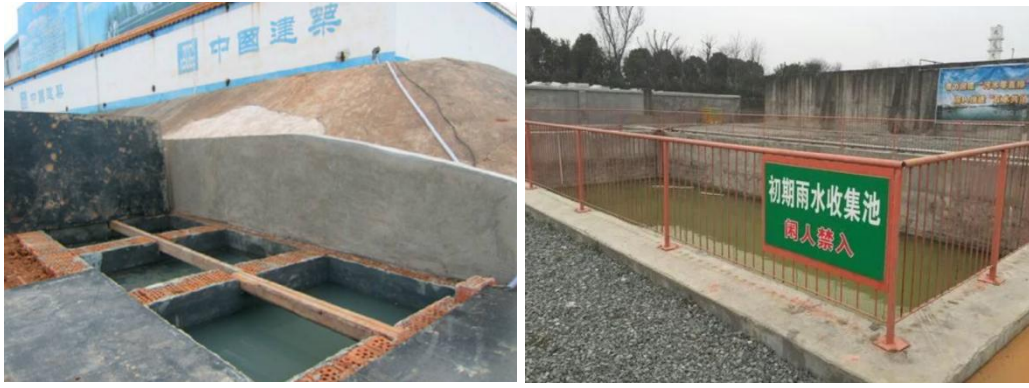
图 6.4-1 沉砂池（左）与雨水收集池（右）
